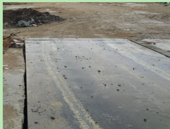
图 3-4 施工出入口洗车平台
