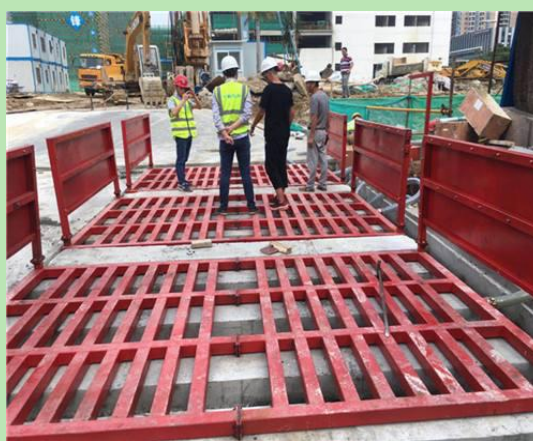
图 3-4 施工出入口洗车平台
